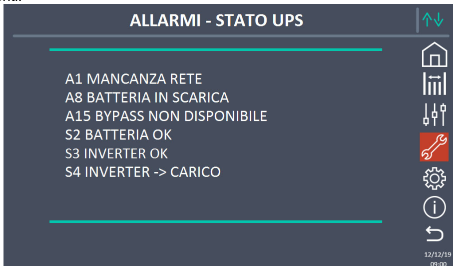
Figura 13 – Sezione allarmi, stato UPS
